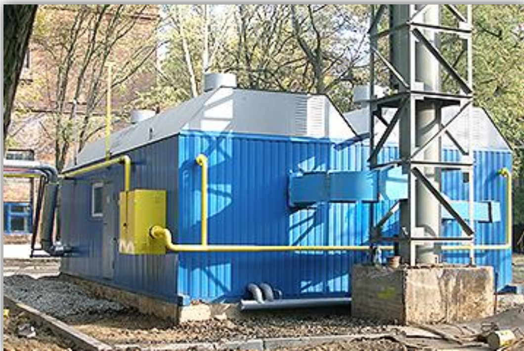
Рисунок 6.11.1 Блочно-модульная водогрейная котельная.
